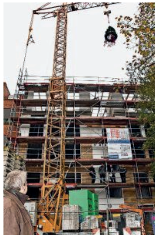
Seit Freitag baumelt der Richtkranz über der Bussestraße 5. Die neuen Mietwohnungen sollen 2018 fertig sein. Foto Scheschonka
